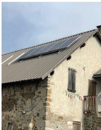
Le gîte des Oustaus, près du lac de Peyssier, est désormais alimenté en électricité par des panneaux photovoltaïques.
